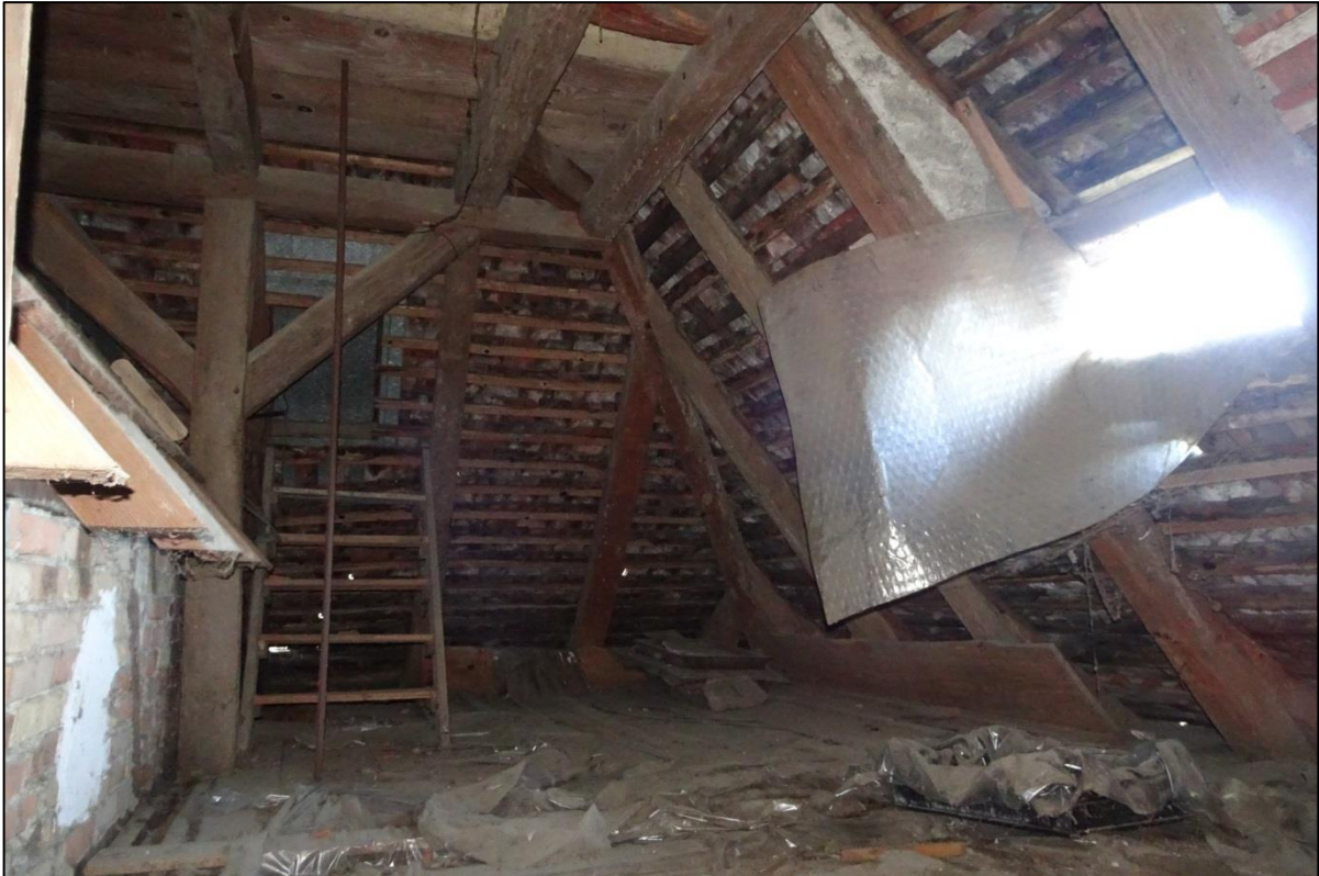
Abb. 4: Dachstuhl des Fachwerkhause mit großer Einflugmöglichkeit für Fledermäuse.
